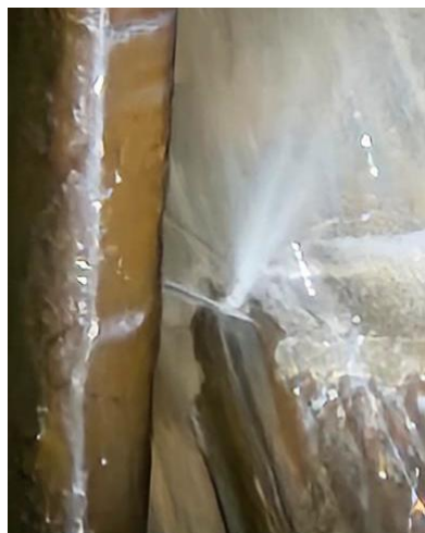
Gambar 1 Kondisi kebocoran pada riser wall tube
